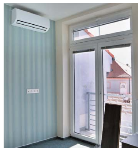
KLIMATIZACE V budoucích apartmánech nechybí nová klimatizace.
